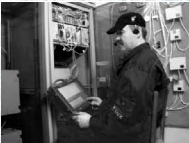
Рис. 4. Один из самых опытных монтажников оптического оборудования инженер-установщик Биза Г.В. проводит с помощью рефлектометра контроль качества сварки пигтейлов с оптическим кабелем на головной станции
