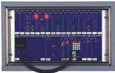
Внешний вид оборудования ретранслятора в А 2 Т
