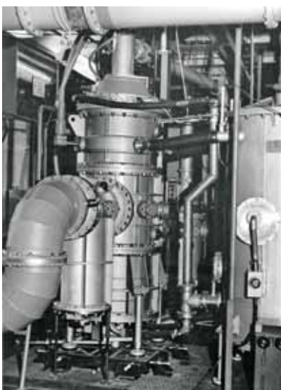
Мощный ВЧ-генератор с выходной мощностью 5 МВт
